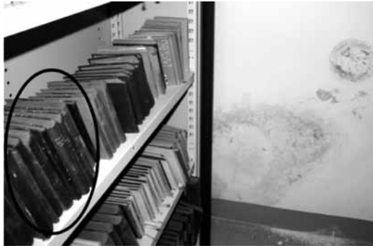
Slika 13: Vdor vlage skozi zunanjo steno – madeži na steni in plesen na knjigah (obkroženo)
